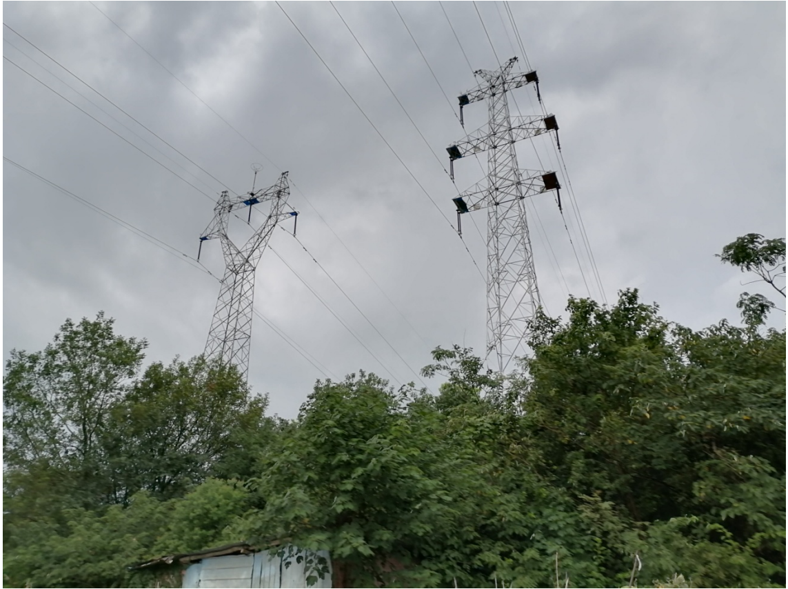
架空的电力线（杆高约 40 米）沿西南向横穿厂区闲置设施区。
