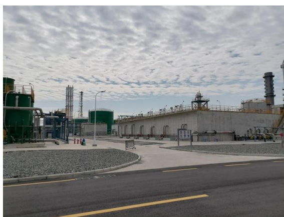
雨水监控及事故池及污水处理场
