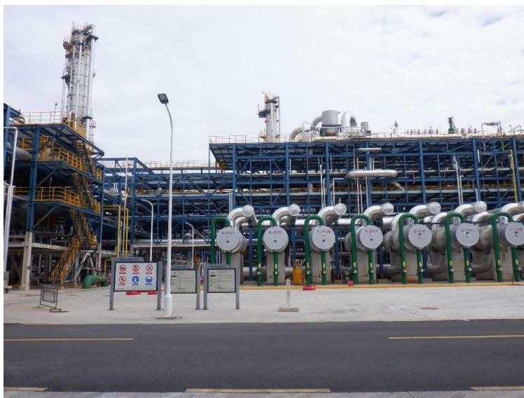
图 7 PO/SM 装置东侧扩建项目乙烯装置
